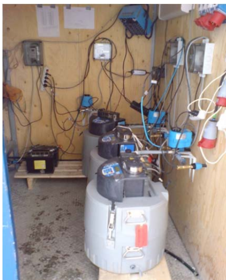
Figur 10: Mätstation Lagga, Uppsala. Automatisk provtagningsutrustning.
